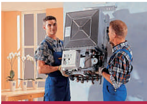
... bis zur Inbetriebnahme der neuen Erdgasheizung.
